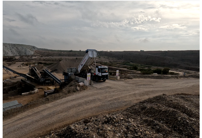
Figura 9: Posición de descarga en tolva.
